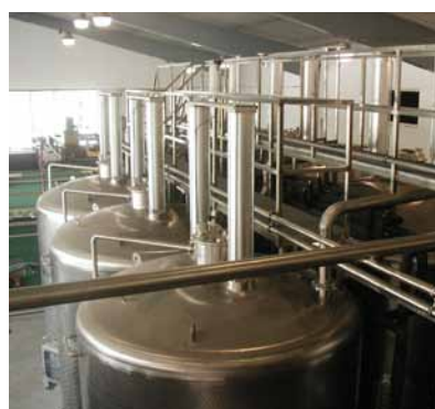
Dávkovací nádrže a zásobníky
