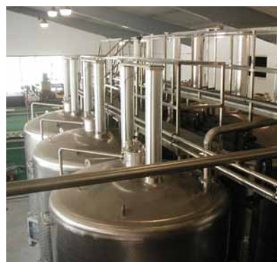
Dávkovací nádrže a zásobníky
